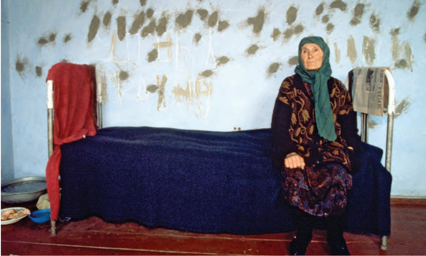
Le conflit de 1992 opposant les groupes ethniques ingouche et ossète a entraîné une épuration ethnique et la destruction massive d'habitations. Cette femme se trouve dans sa maison gravement endommagée, criblée de balles. Le 1er janvier 1997, en Ossétie du Nord, Fédération de Russie. Crédit : Photo ONU/T. Bolstad
